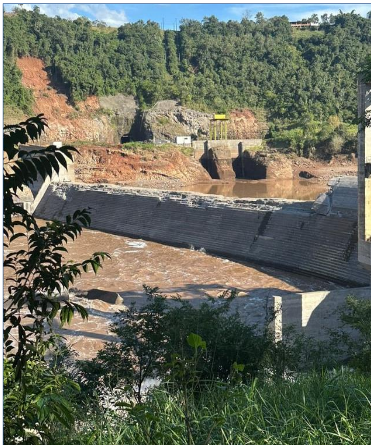
Figura 11: Rompimento da Barragem 14 de Julho. Fonte: Redes Sociais
