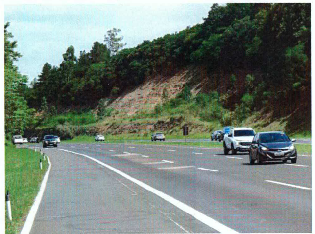
Figura 8. Erosão provocada pela expansão da BR-290 dentro dos limites do PMMBP.
