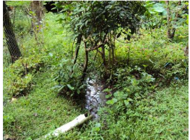
Figura 36 - Drenagem despejada dentro da área do Parque através de duas tubulações distintas.
