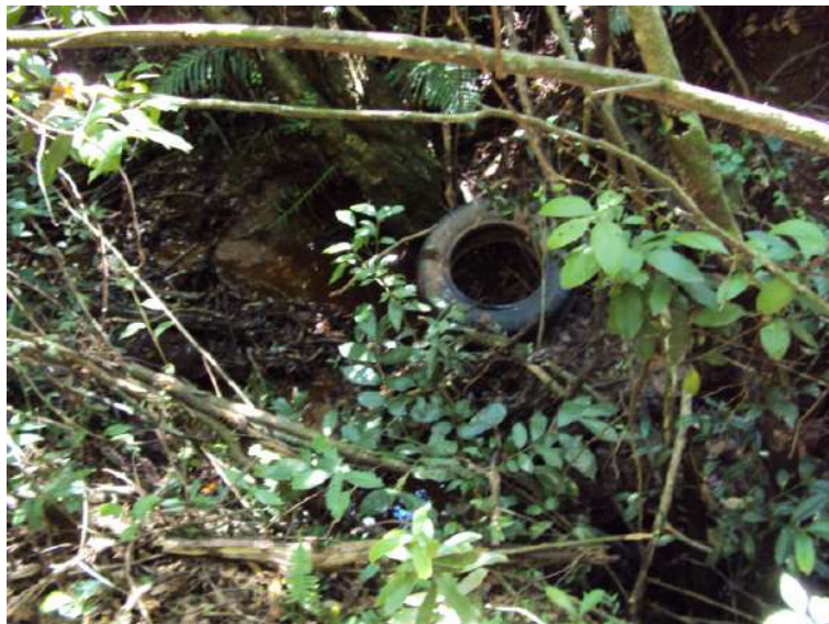
Figura 48 - Trecho com presença de lixo próximo a desembocadura no arroio Vila Kunz.
