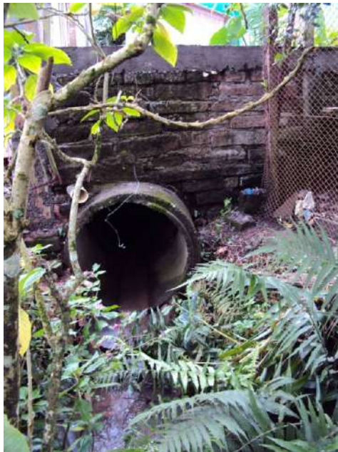
Figura 35 – Drenagem despejada dentro da área do Parque através de duas tubulações distintas.
