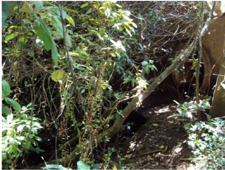
Figura 47 - Tubulação sob a estrada de acesso a sede principal.
