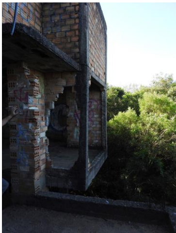
Foto 1. Estrutura de casa abandonada.
